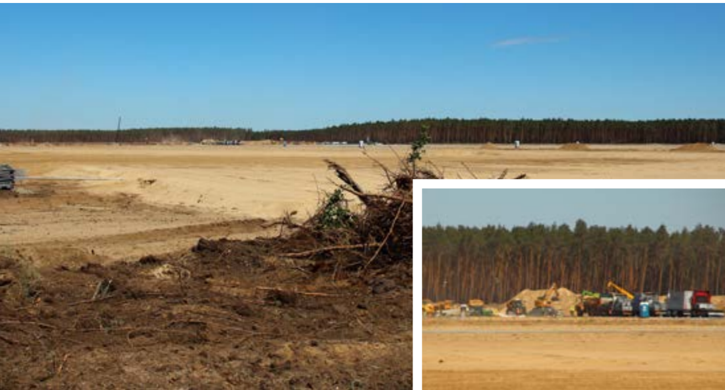
Innerhalb weniger Tage wurde der gesamte Kiefernforst gerodet, um Platz für den Bau von Teslas "Gigafactory" zu machen (Aufnahmen vom 3. Juni 2020).
